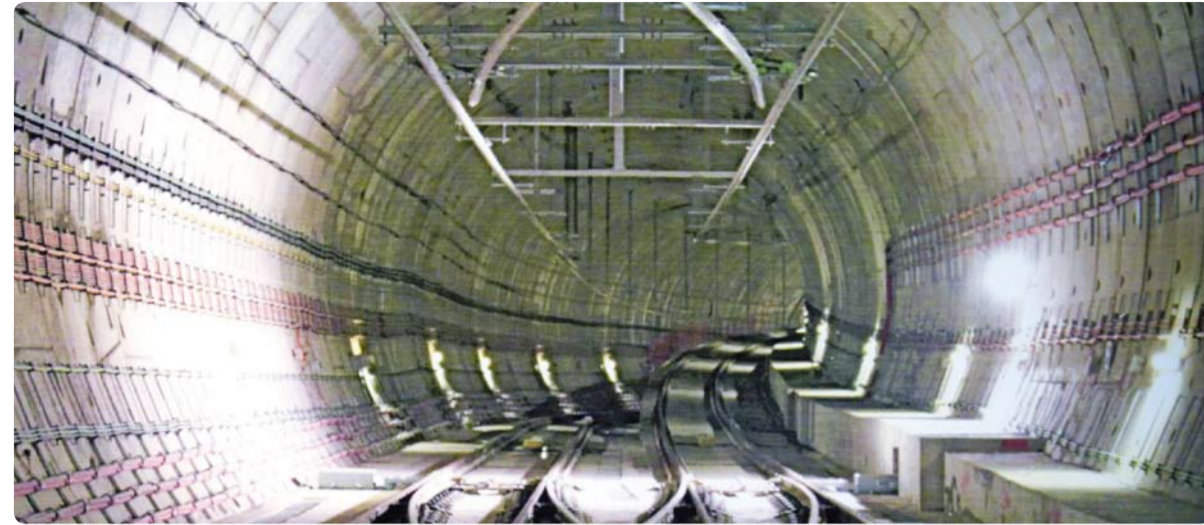
Instalaciones en el túnel de la Línea 9 del Metro de Barcelona.
