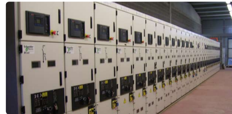
Instalaciones de alta tensión para la desaladora del Prat de Llobregat, Barcelona.
