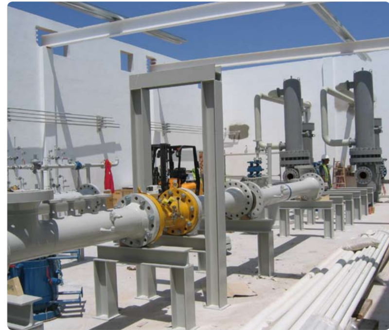
Estación de regulación para Enagás. Dénia, Valencia.
