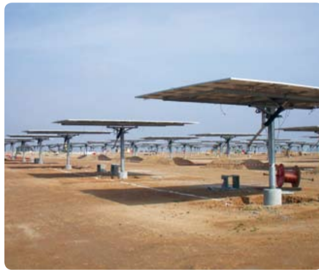
Solmir. Planta solar fotovoltaica. Miralcamp, Lleida.
